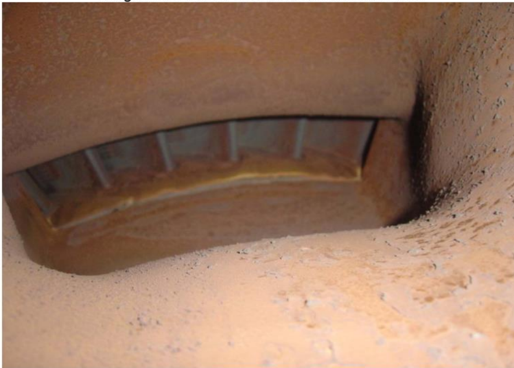
Imagen: INTERIOR TURBINA 15 Diciembre 2005
